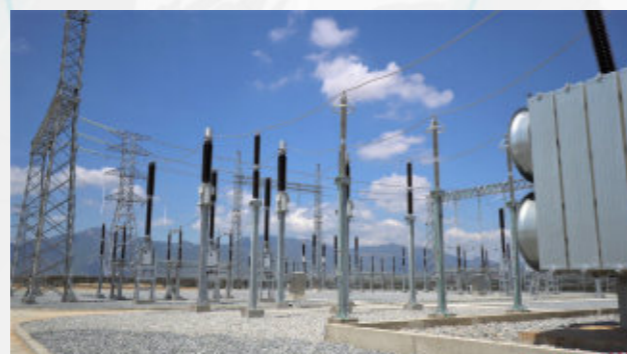
ĐZ 220kV điện mặt trời BIM - Ninh Thuận
