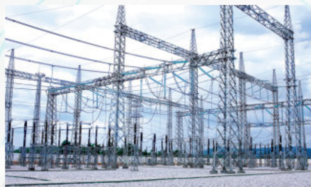
Trạm biến áp Bắc Kạn
